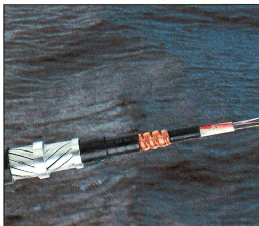
Im Genfersee versenktes Unterwasserkabel mit 40 Glasfasern
