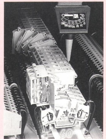
Les nouvelles bornes à fusibles
