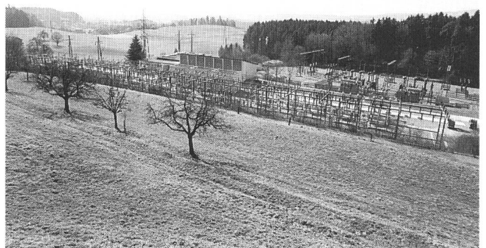
Gemeinsame Freiluftschaltanlage NOK/EKZ in Aathal. Die in Höchstspannung angelieferte elektrische Energie wird für den Weitertransport auf 110, 50 oder 16 kV heruntertransformiert (Foto: EKZ)
