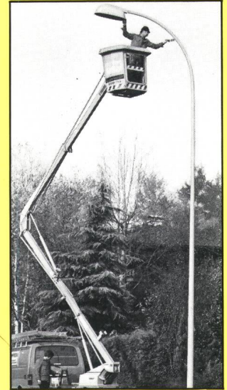
Korrosionsschutz an Stahlkandelabern
