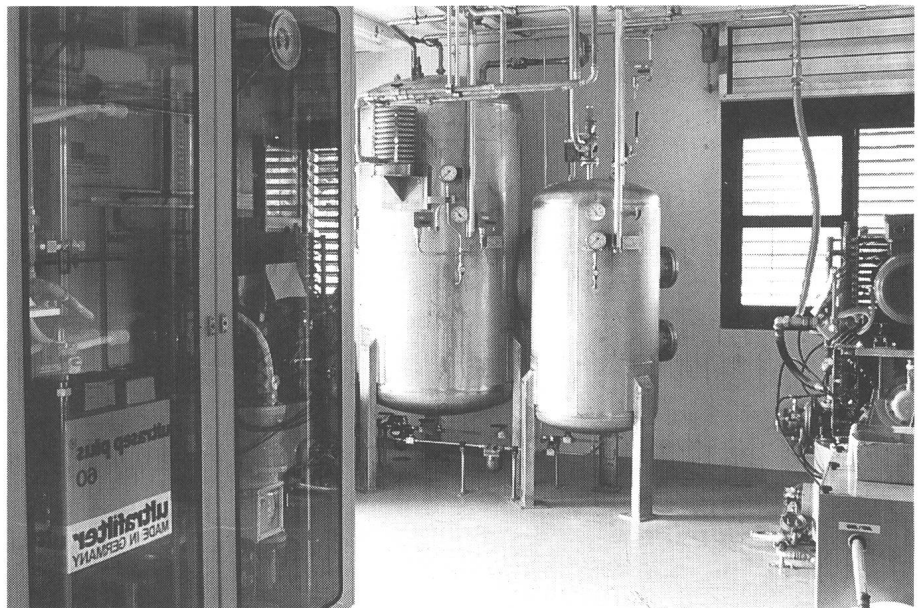
Bild 2 Produktionsteil der Wasserstoffanlage
