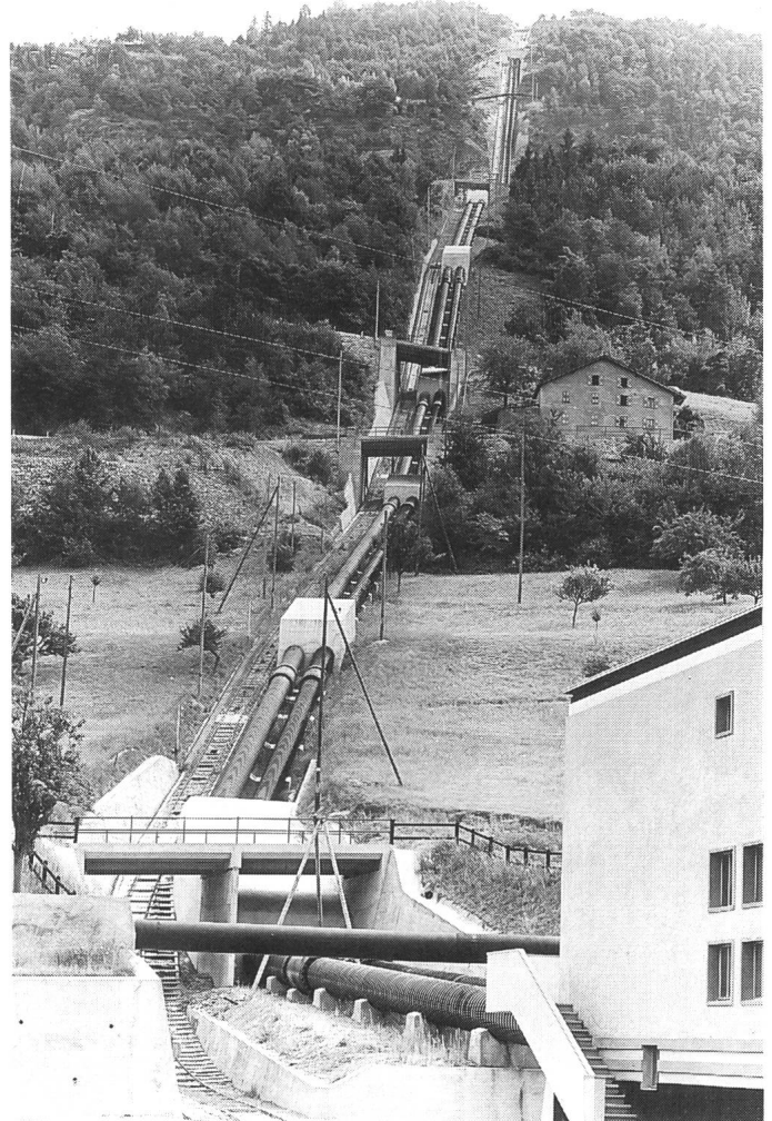
Bild 34 Teil der rund 5,5 km langen Druckleitung zum Kraftwerk Chandoline im Wallis Foto EOS, Lausanne
