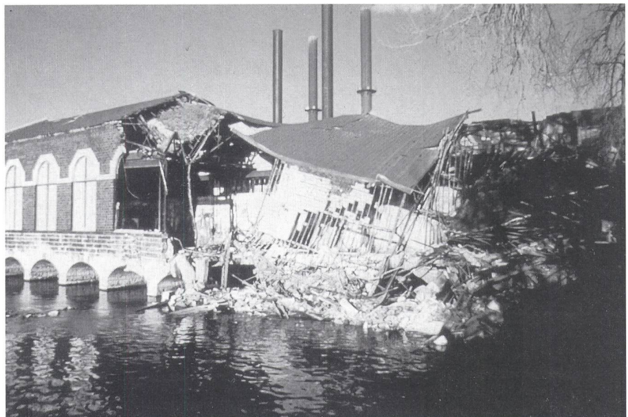
Bild 1 Das Wasserkraftwerk St. Anthony Falls in Minneapolis, USA, nach dem Einsturz infolge Unterspülung
