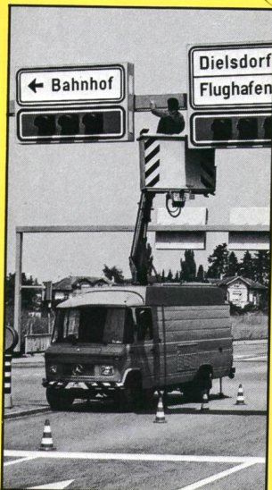
Korrosionsschutz an Signalanlagen
