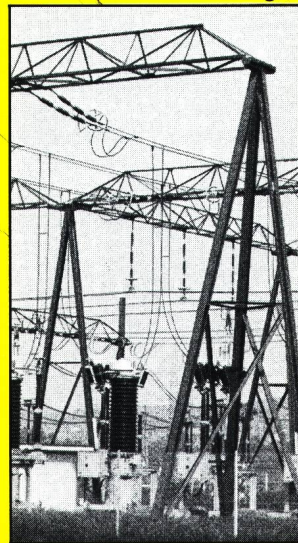
Korrosionsschutz an Schaltanlagen
