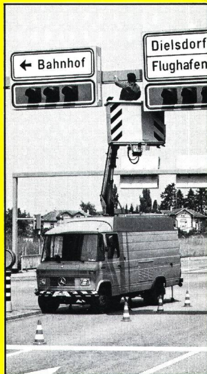
Korrosionsschutz an Signalanlagen
