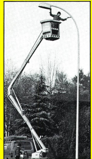
Korrosionsschutz an Stahlkandelabern
