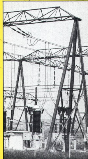
Korrosionsschutz an Schaltanlagen
