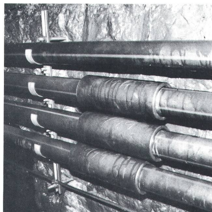
Figur 8 Kabel-Rohrblockanlage mit Muffenstelle im Albulatunnel
