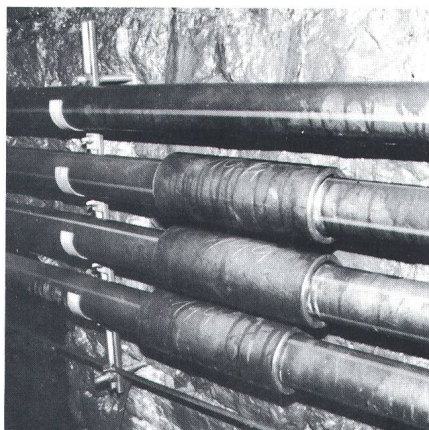
Figur 8 Kabel-Rohrblockanlage mit Muffenstelle im Albulatunnel
