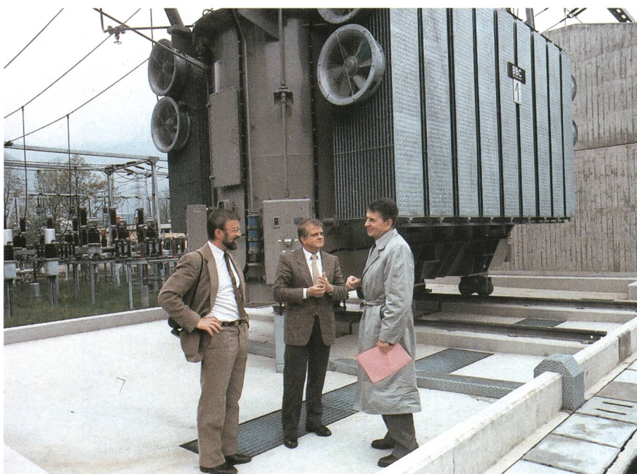
Unterwerk Mendrisio mit 2x100 MVA Transformatorenleistung 150 kV/50 kV anlässlich der Inspektion der Erdungsmessungen durch das Eidg. Starkstrominspektorat
