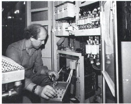
Fig. 3 Leistungs- und Steuerteil des Dreiphasen-Hilfswechselrichters (Im Schwenkrahmen in Bildmitte)
