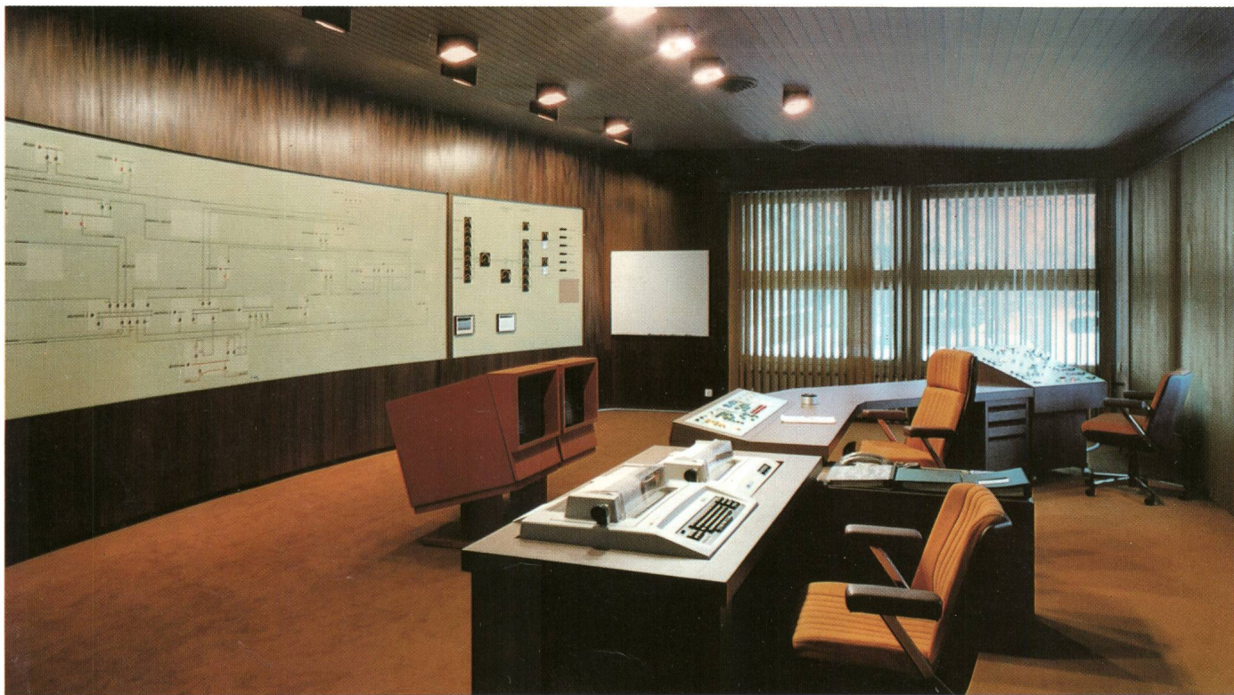
Netzleitstelle der Elektrizitätswerke Freiburg
