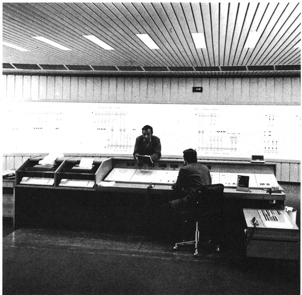
Regionale Leitstelle in der Unterstation Bassecourt der BKW
