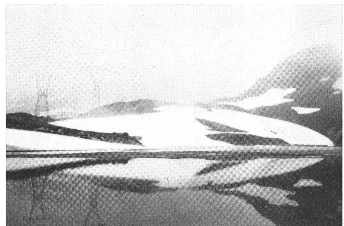
Fig. 3 150-kV- und 220-kV-Leitungen der KWB auf dem Berninapass
