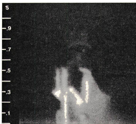
Fig. 2 Thermovisionsfoto von Trennerkontakt mit Isotherme Die weissen Zonen haben alle dieselbe Temperatur
