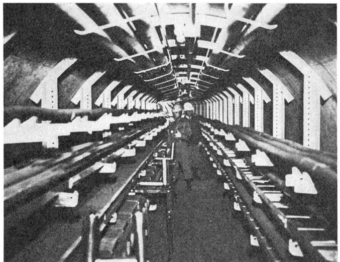
Fig. 2 165-kV-Kabel in einem Mehrzweckschacht
