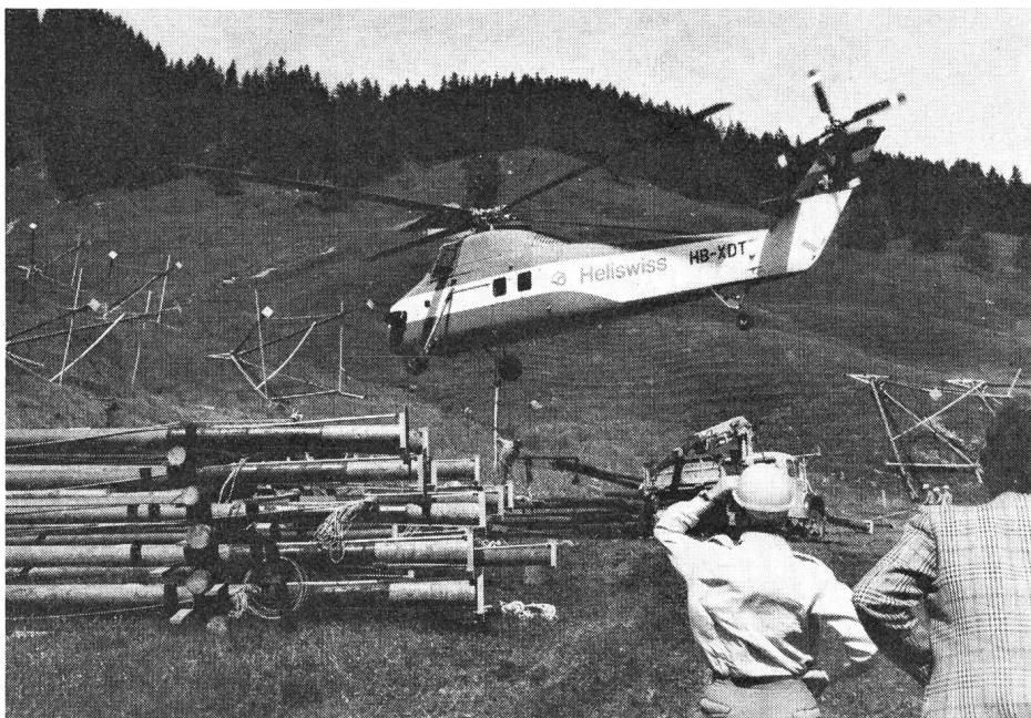
Fig. 6 Construction d'une ligne moyenne tension 17 kV en zone de montagne (Schweinsberg en Singine)
