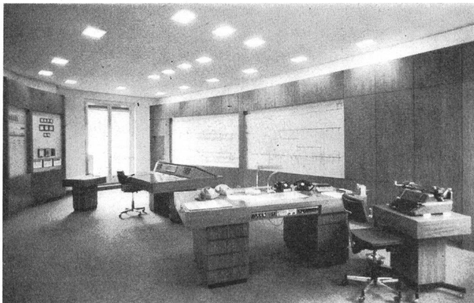
Fig. 3 Centrale de dispatching à Pierre-à-Bot
