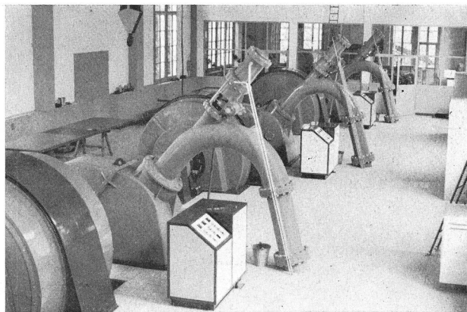
Fig. 2 Centrale de la Peuffeyre: Salle des machines
