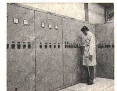
Steuerschranke für Sanitär- und Lüftungsanlagen im Hotel Zürich
