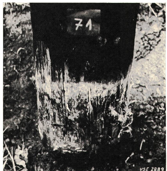
Fig. 1 Leitungsstange mit Kupfersulfat imprägniert und in der Bodenzone durch Poria vaillantii vermorscht. Vorn und rechts an der Stange für diesen Pilz charakteristische weisse Mycelstränge.
