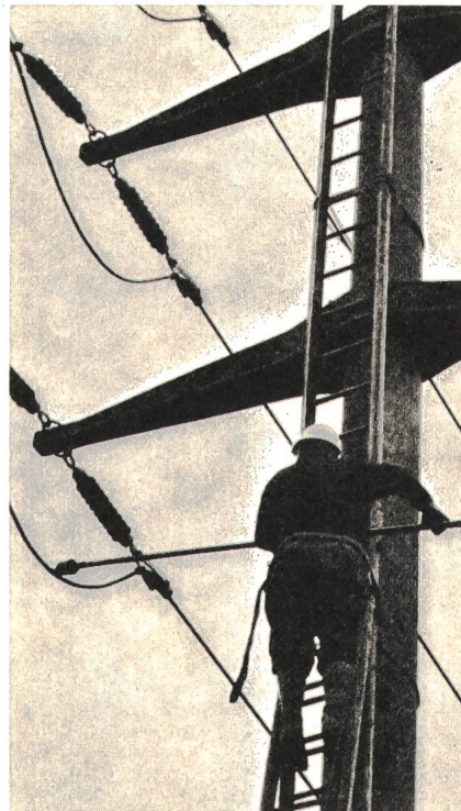
Peyer-Opticest in 50/150 kV Hochspannungsfreileitung
