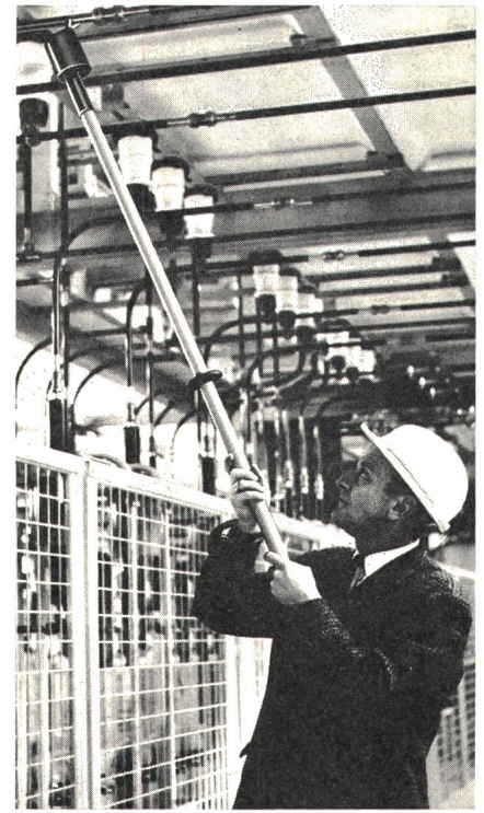
Peyer-Opticest in 16 kV Innenraum-Schaltanlage
