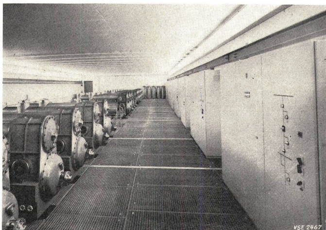
150-kV-Schaltraum und örtliche Steuertafeln
