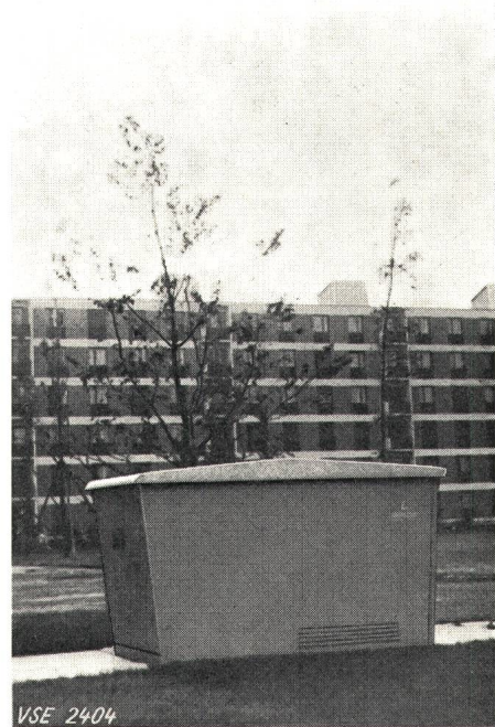
Fig. 11 Kompakt-Transformatorstation 400 kVA, Reihe 20 kV
