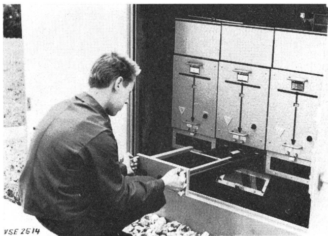
Fig. 11 Spannungskontrolle in vollisolierter Anlage
