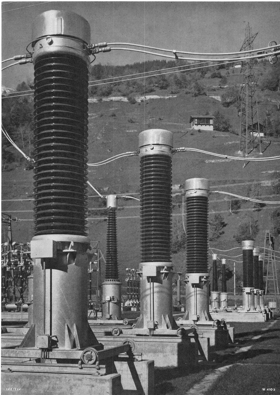
Spannungswandler 420 kV mit erhöhtem Untergestell in einer schweizerischen Verteilstation.
