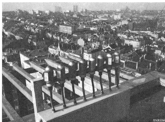
Fig. 14 Cellules photo-électriques commandant l'éclairage des tunnels des boulevards de Bruxelles (Belgique)
