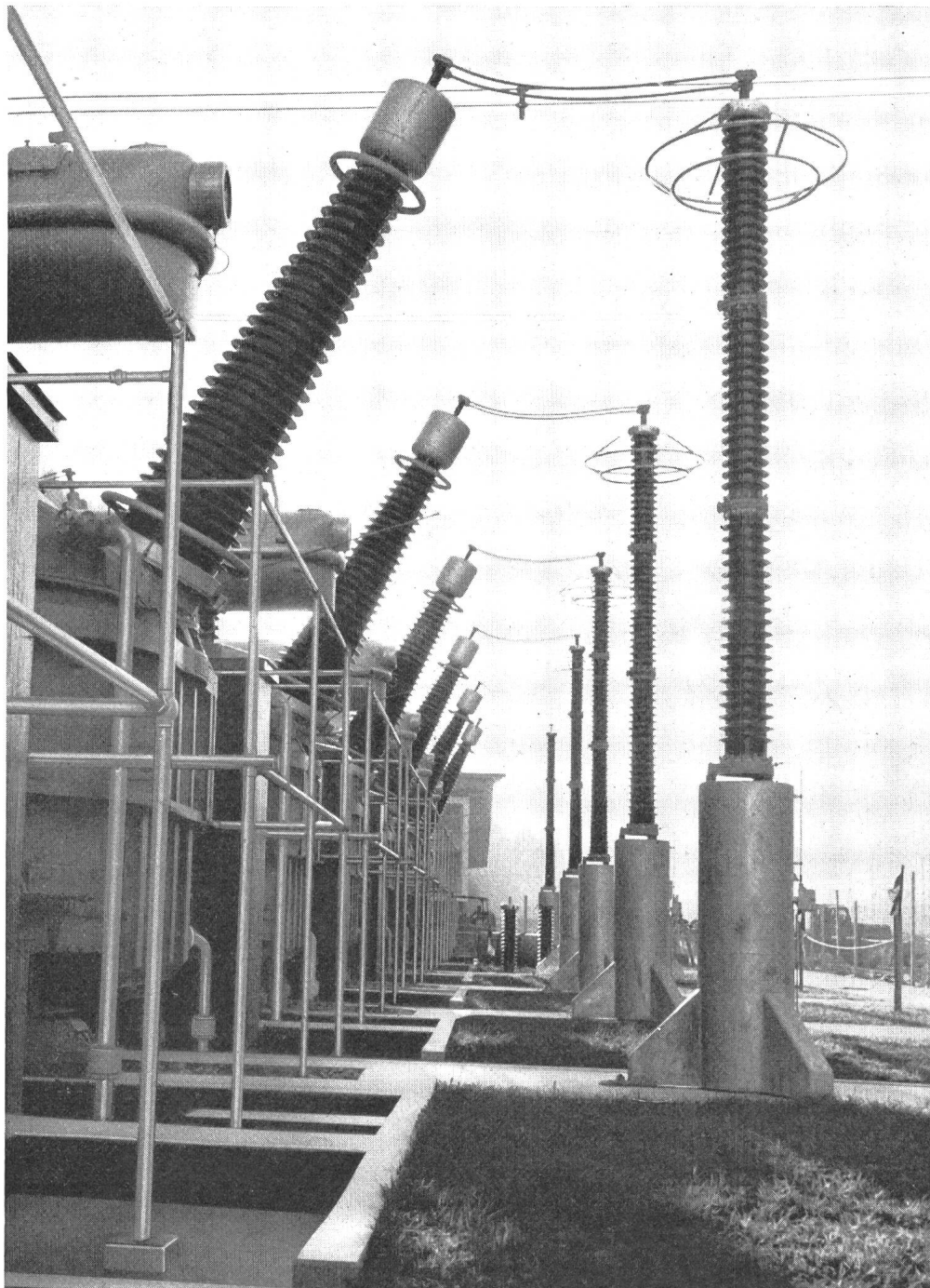
Kraftwerke Vorderrhein AG Zentrale Tavanasa
