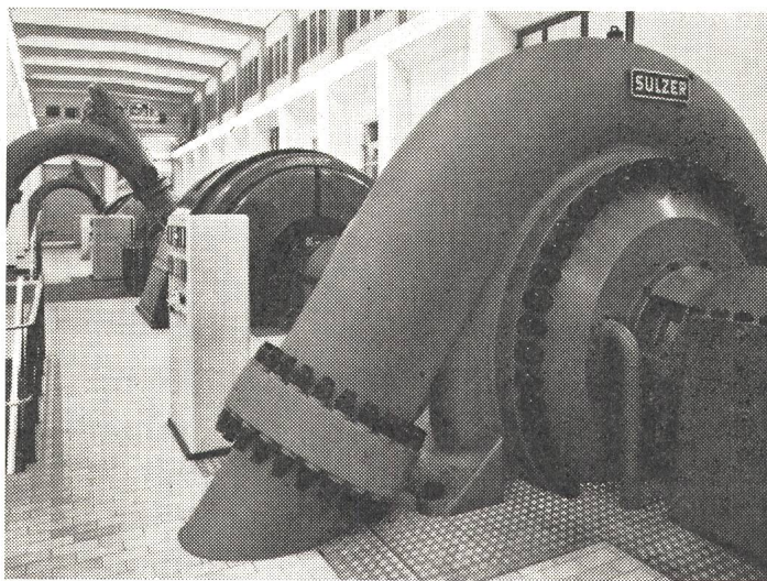
Sulzer-Hochdruck-Speicherpumpe in der Zentrale Motec der Gougra Kraftwerke AG
