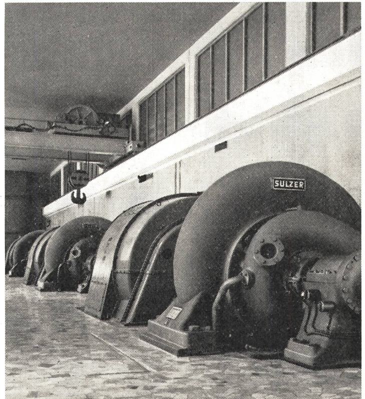
3 Sulzer-Pumpen-Turbinen in der Zentrale Stafel der Grande Dixence S. A.
