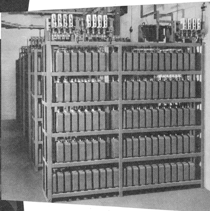
Teilansicht einer vollautomatischen Kondensatorenanlage in einer Grossgläserei
