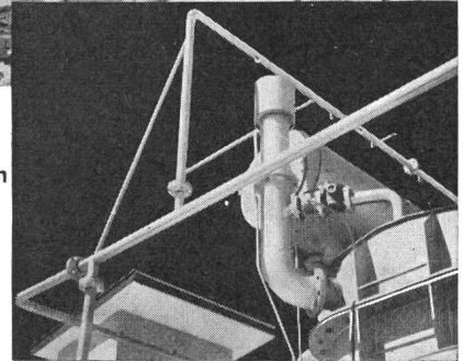
Centrale de Göschenen Protection incendie par eau pulvérisée
