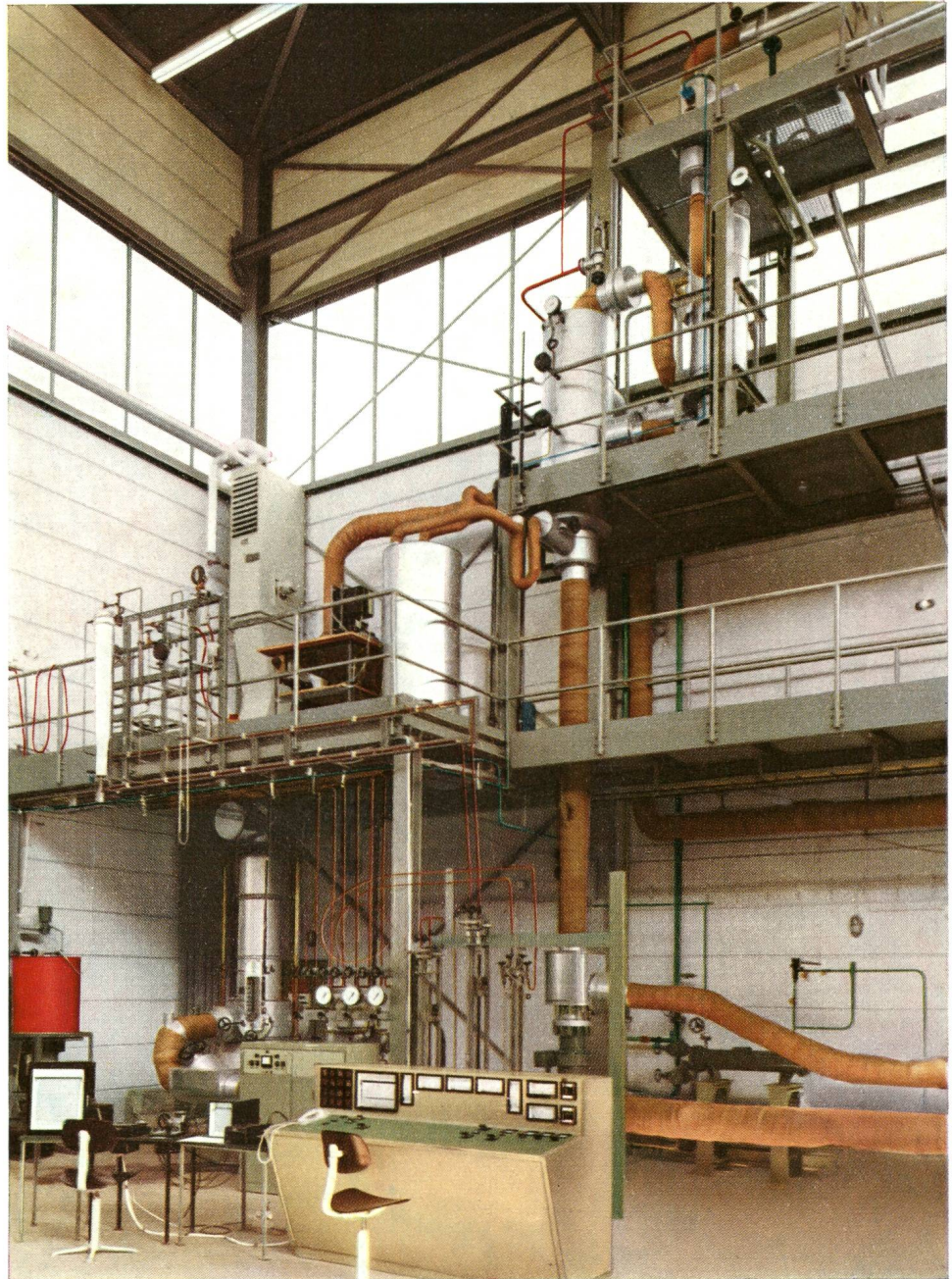
Fig. 3 Teilansicht des Wärmeprüfstandes
