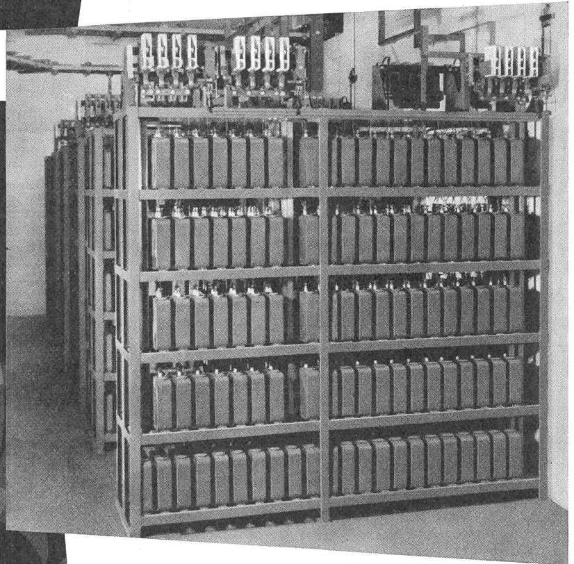
Teilansicht einer vollautomatischen Kondensatorenanlage in einer Grossgiesserei
