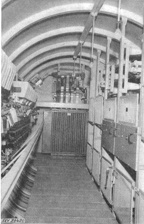
Fig. 3 L'intérieur de la cabine équipée
