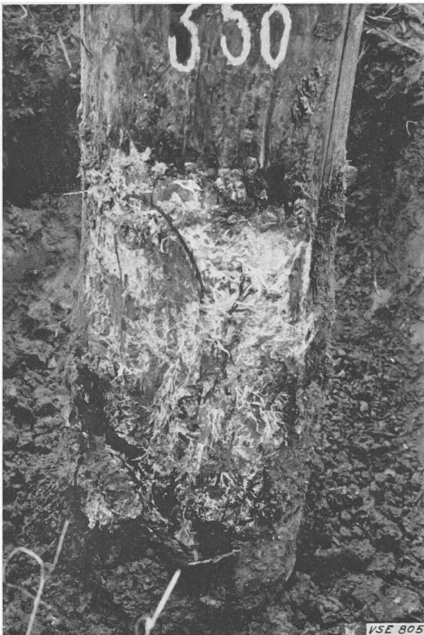
Fig. 4 Mit Ölstrich nachgepflegte Stange, von Poria vaporaria befallen
