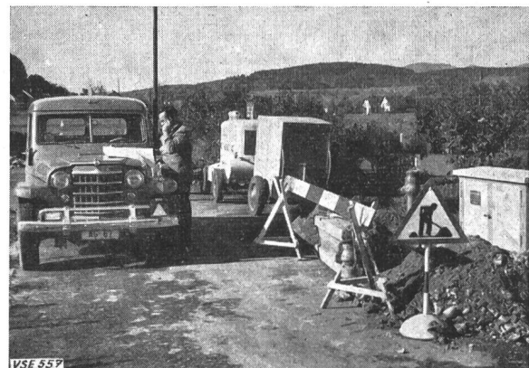
Fig. 3 Jeep des Chefmonteurs für Freileitungs- und Kabelbau auf einer Baustelle Beantwortung eines radiotelephonischen Anrufes
