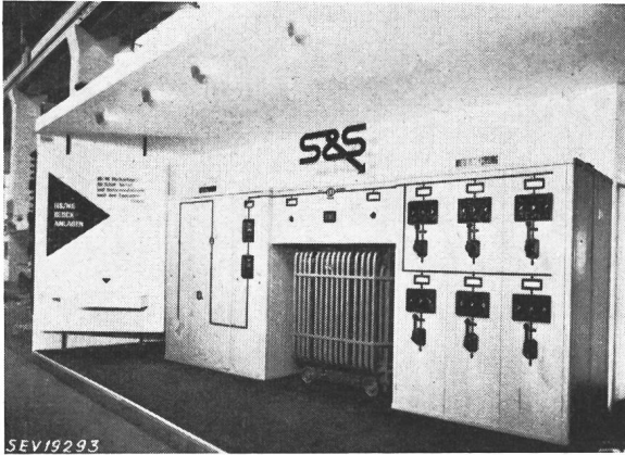
Fig. 3 Block-Station an der Mustermesse 1951 Nennspannung 20 kV/380 V Transformatorleistung 400 kVA
