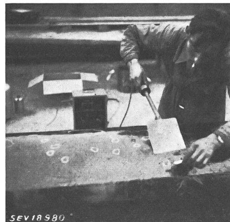
Fig. 4 Contrôle électrique à haute tension d'une isolation «Vetro-Waberit» Les endroits poreux décelés par l'arc sont marqués à la craie puis refondus au chalumeau (Strassenbaumaterial A.-G., Berne)
