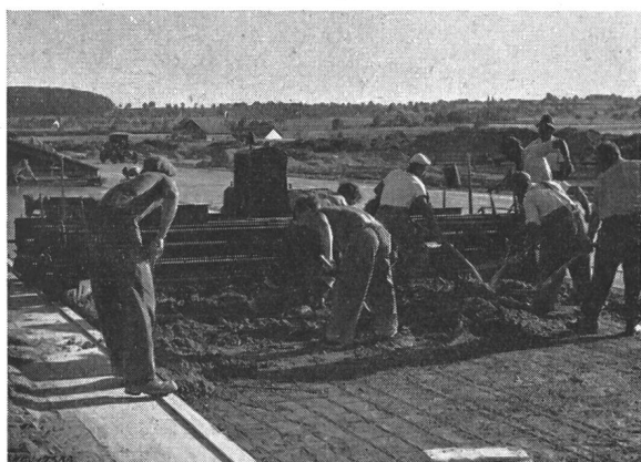
Fig. 8 Einbau des 27 cm starken Betonbelages mit dem Betonstrassen-Fertiger Im Vordergrund die Stahldrahtarmierung
