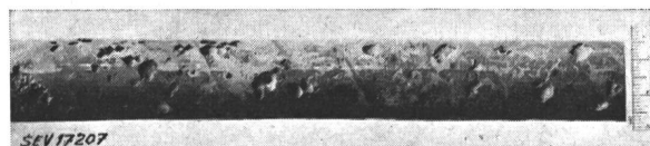
Fig. 7 Câble corrodé par électrolyse
