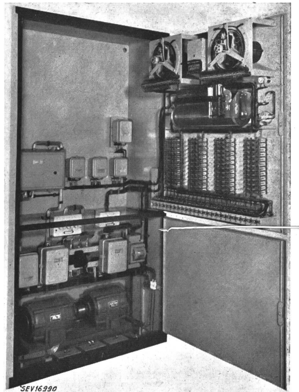
Fig. 6 Schalttafel von innen gesehen Unten im Kasten: Tonfrequenzumformer 50/2000 Hz, 2,5 kW
