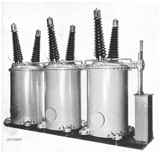
Fig. 22a. Gruppe von drei einpoligen 150-kV-Oelschaltern, 400 A, 1500 MVA, mit 6facher Unterbrechung (geschlossen).
