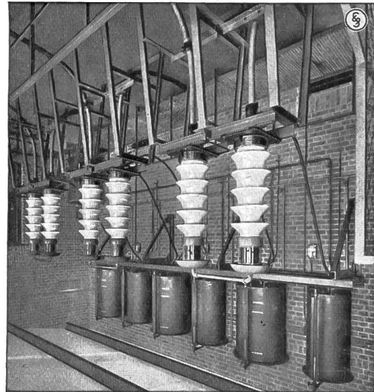
Fig. 5. Trennstelle zum Oelkabel 100 kV.
