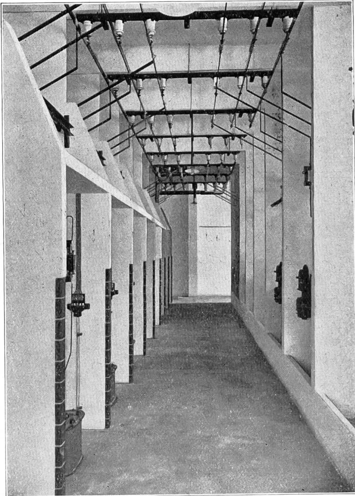
Fig. 22. Barres collectrices à 5600 volts.
