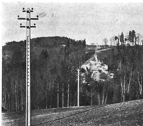
Fig. 9. Ligne 32 000 volts sur mât en béton Hauterive-Romont.
