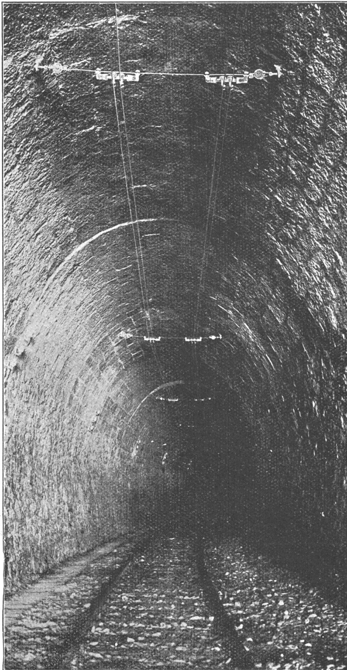
Abb. 14. Anordnung der Kontaktleitung im Tunnel.
