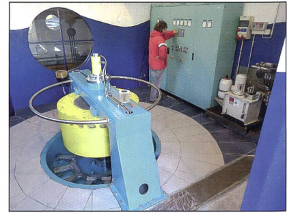
Abb. 3: Generator eines Kleinwasserkraftwerks.
