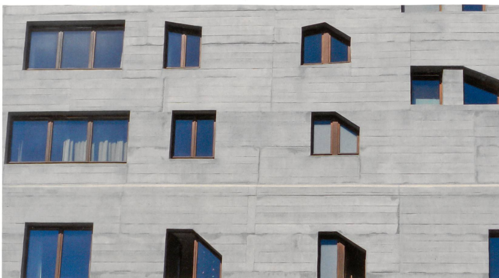
Radikale Instandsetzungsarbeit aus den 1990er-Jahren: Die gesamte Fassade des rückwärtigen Bühnentrakts (1800 m 2 ) wurde bis zu 4 cm tief abgetragen und durch neuen Beton von 7 cm Stärke ersetzt. Silikonmatrizen kopierten die originale Betontextur.
