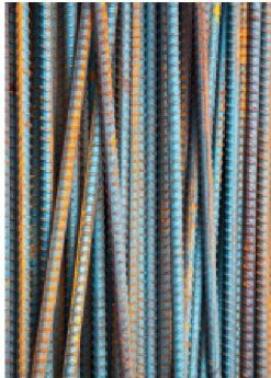
Angerostete Bewehrungsstäbe (KEYSTONE/CARO/Felipe Rodriguez)
